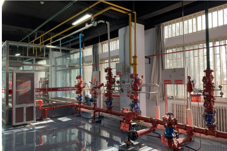
图 1.1 消防技能训练中心—自动喷水灭火系统实景
